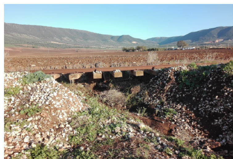
f.3: Uno dei punti in cui è necessario l'intervento SP6
