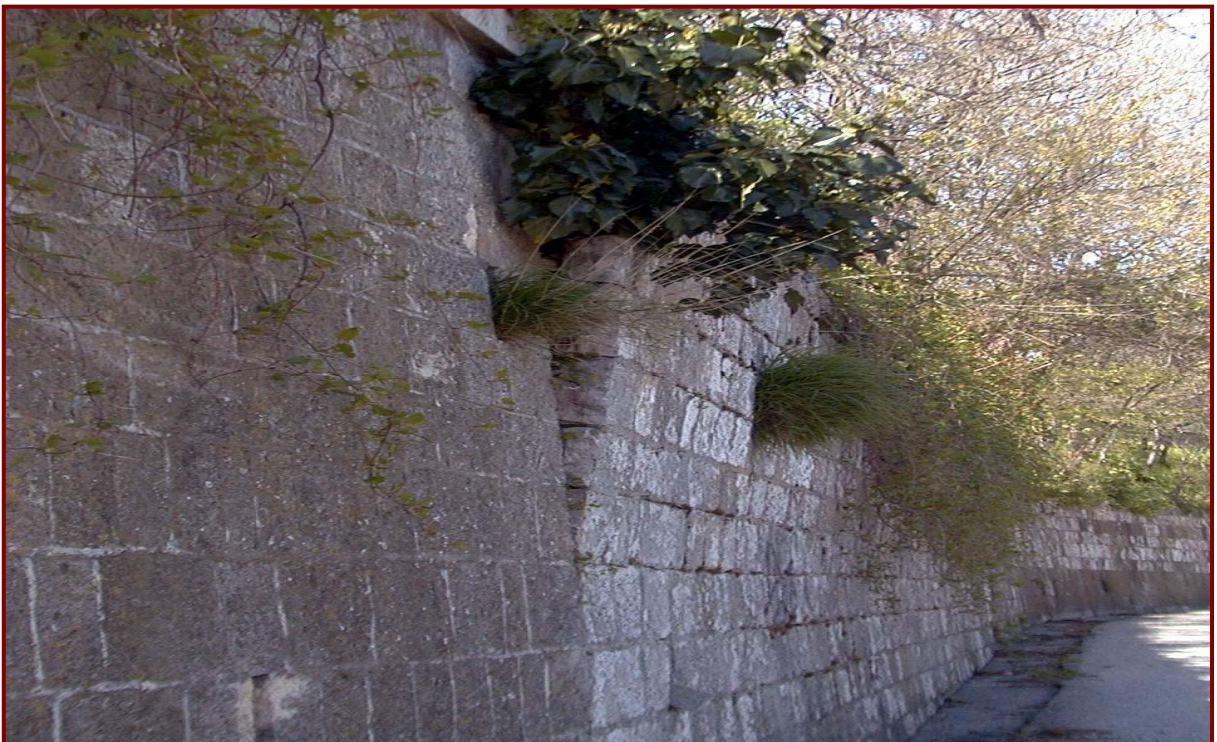
Fig. 44 – Cedimento del muro di sostegno a causa della spinta di terreni conglomeratici e ghiaioso-sabbiosi in Via S. Rocco a Sant'Agata di Puglia (da Mossa, 2002)
