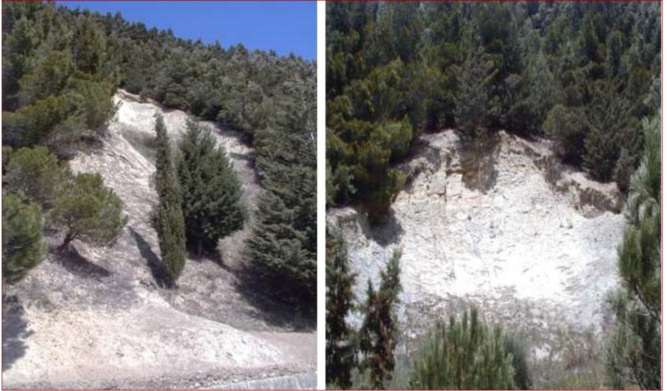
Figg. 132-133 – Scivolamento rotazionale in località Fornace Le Fosse lungo la strada provinciale S.Agata - Candela
