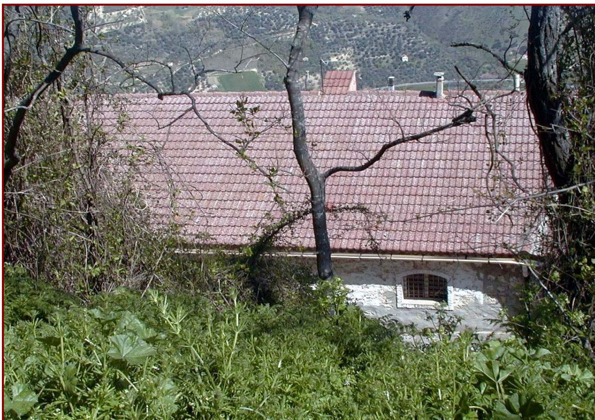
Fig. 45 – Abitazione fatta evacuare ed espropriata a causa dell'elevato di rischio di frana in Via S. Rocco - S. Agata di Puglia. (da Mossa, 2002)
