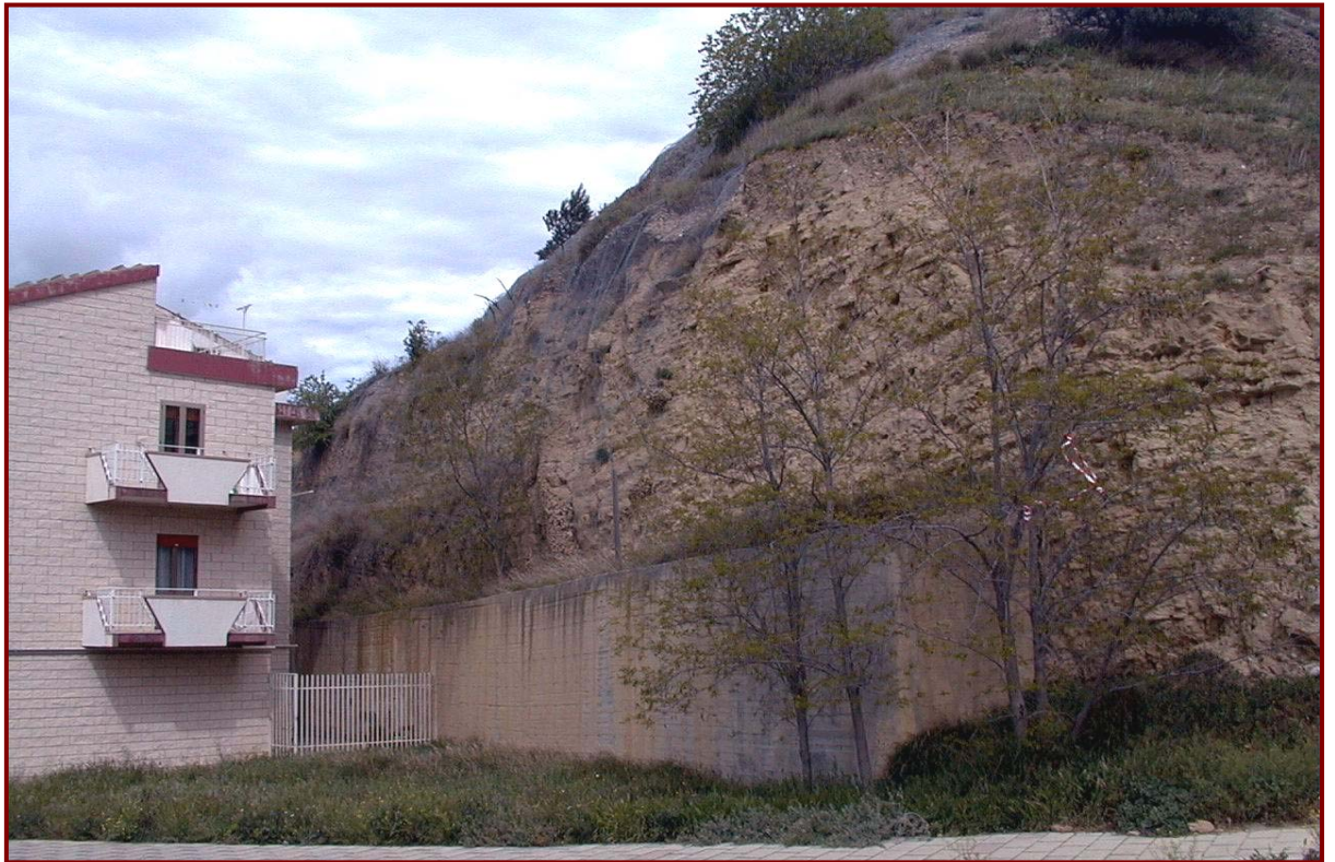
Fig. 47 - Reti di protezione su litotipi sabbioso-arenacei in Accadia (da Mossa, 2002)
