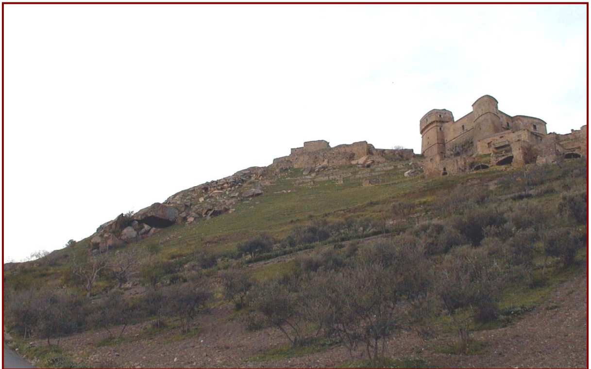
Fig. 43 – Frana da crollo in arenarie quarzose e marne in località Sotto la Cittadella (Castello) nel Comune di Rocchetta S. Antonio (da Mossa, 2002)
