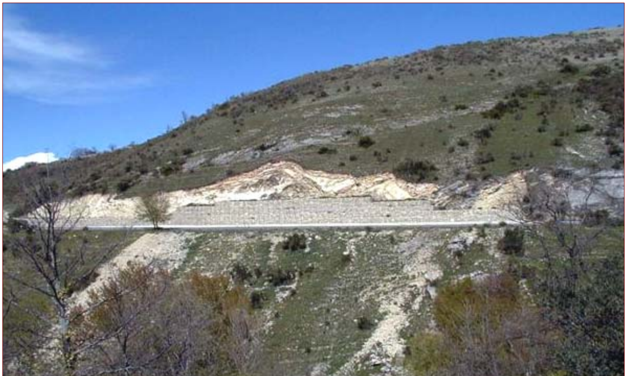
Fig. 134 – Muro di contenimento realizzato per lo scivolamento traslativo che ha interessato alternanze di calcari e marne in località Monte Rotondo – Bovino
